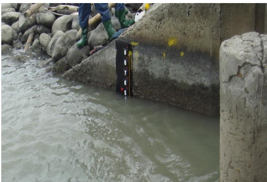
圖 5.1.9-11、水尺架設位置(十孔水門上)。
