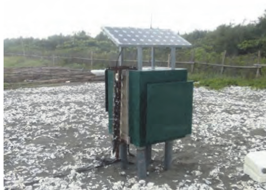
照片5-2-3 波浪溯升高量測之 收錄箱
