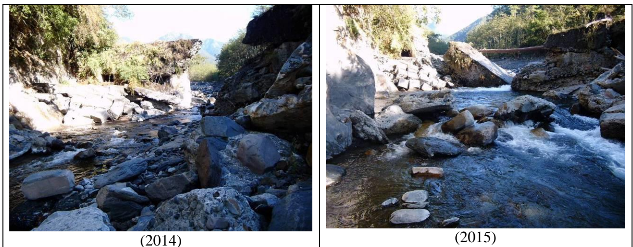
照片 2-13 右岸壩體遭破壞
