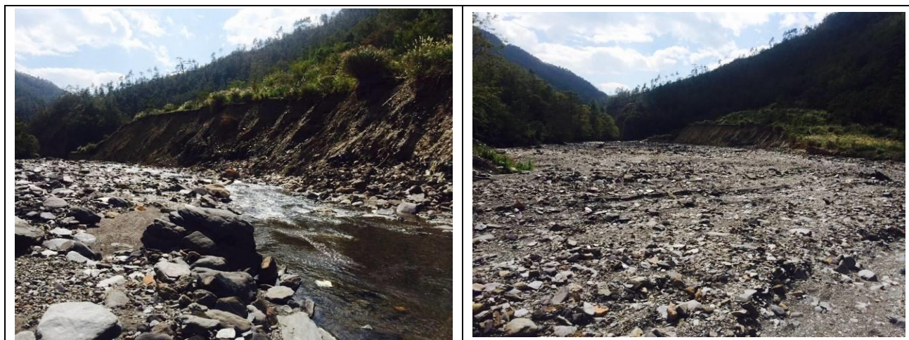
照片 2-4 右岸崩塌情況嚴重 (資料來源：本研究團隊)
