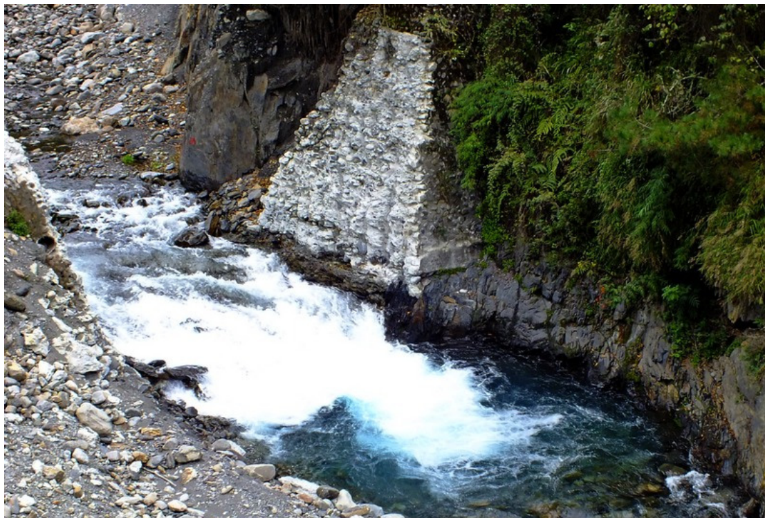
圖 10-15、一號壩拆除後下方沖刷形成深潭。資料來源：本研究調查。
