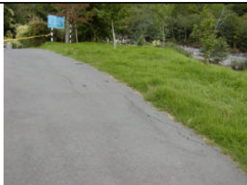
照片 6-23 遊客中心前路面龜裂
