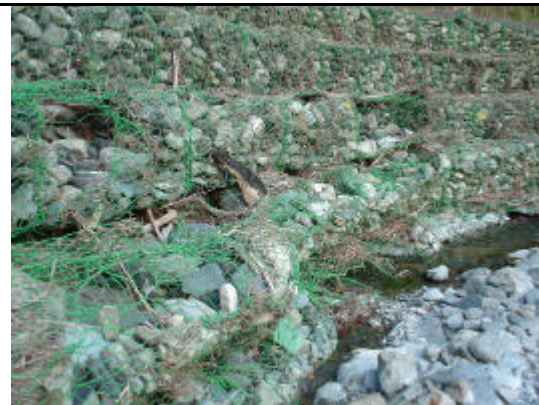
照片 2-31 斷面 2-3 蛇籠破壞
