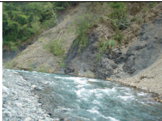
照片 6-3 七家灣溪崩坍(9/19 現勘)
