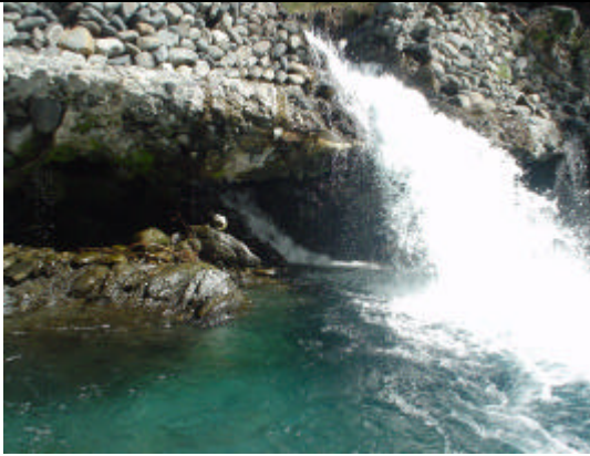
照片 3-9 二號壩壩基漏水現象(2004-11)
