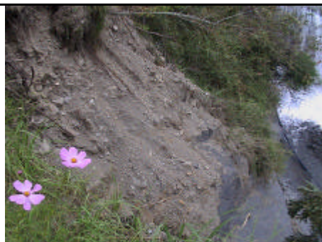
照片 6-25 七家灣溪一號壩邊坡沖刷
