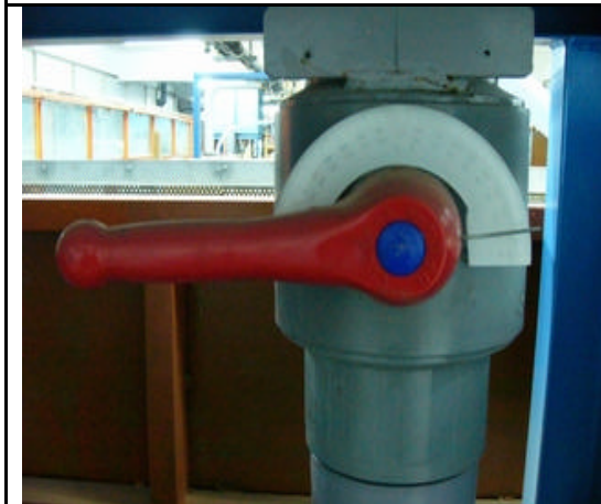
照片 5-3 流量控制閥門
