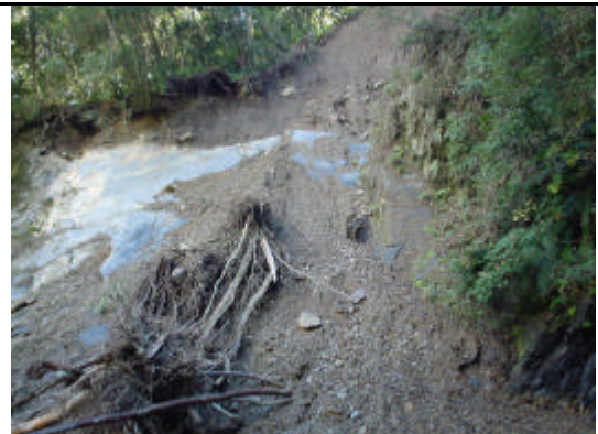
照片 2-12 斷面 3-16 崩塌(約 5 公尺)
