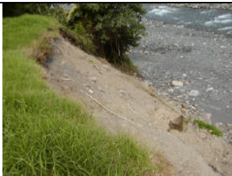
照片 6-22 遊客中心前河岸淘刷
