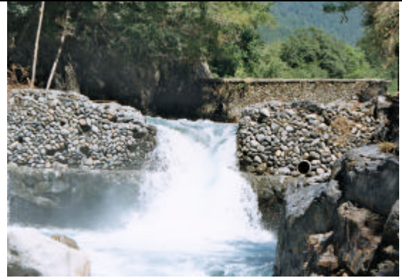
照片 6-11 二號壩壩址現況(颱風過後)
