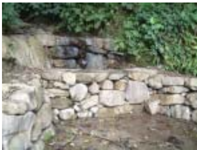
圖 5-20 小規模上邊坡排水路
