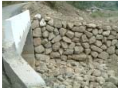
圖 5-17 下邊坡出水口
