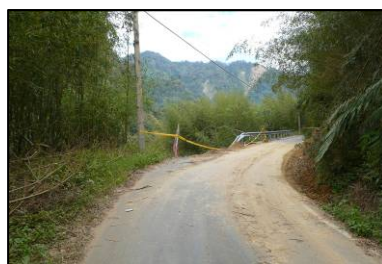
苗 61 線道路地質脆弱，且路幅狹小不適合大巴士進入
