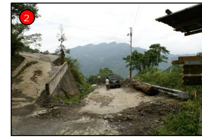
2 竹 63 鄉道之崩塌路段
