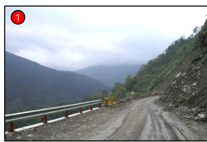
1 大鹿林道 3K 處的道路土石崩落，尚未整建完成，具危險性
