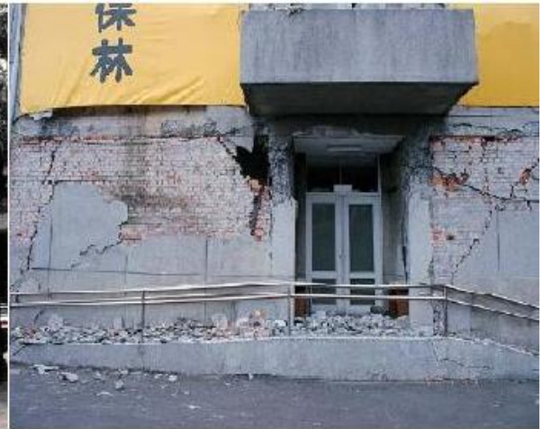
照2-3-2 辦公大樓遭921大地震毀損嚴重 照片來源：東勢林區管理處提供
