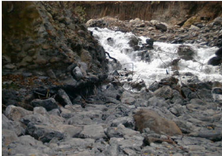
照片 5-10 三號壩壩體拆除後鋼筋裸露
