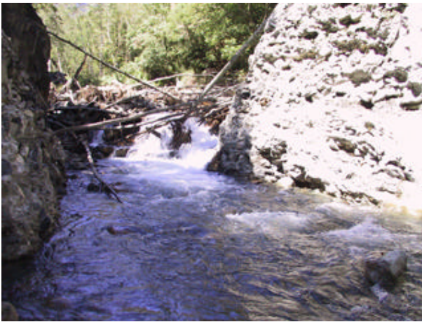
照片 3-8 二號壩上游斷面河道被樹幹堵塞(先前副壩址處)
