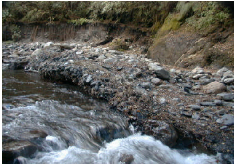
照片 5-8 三號壩上游蛇籠壩被破壞
