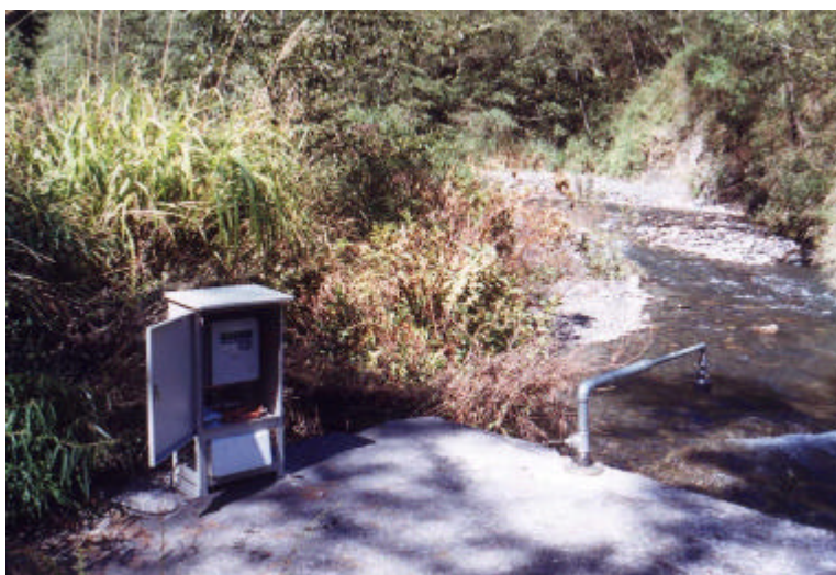
圖 2-2 安裝於一號防砂壩右側翼牆之超音波水位計
