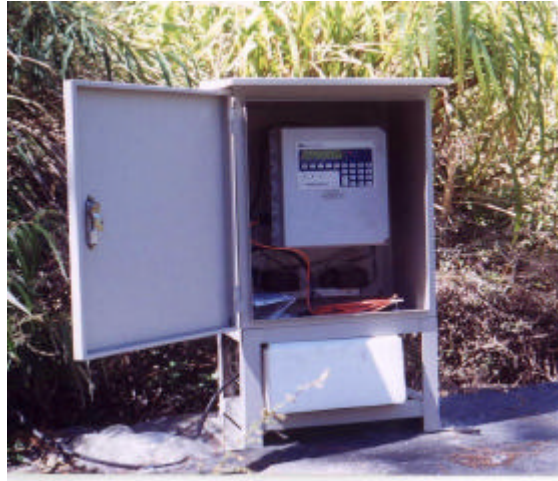
圖 2-3 超音波水位計主機
