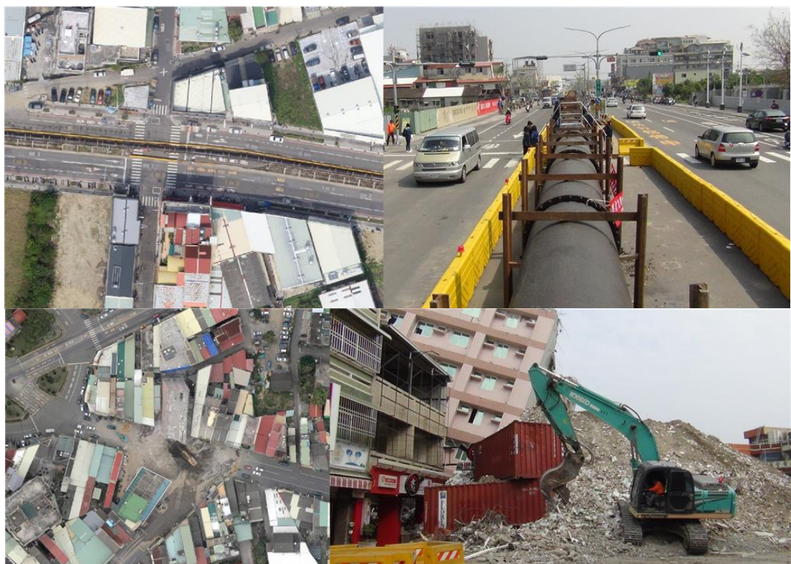
圖 1- 4 1070206 美濃地震造成臺南地區之災害現況及 UAV 拼接影像
