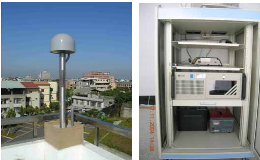
圖 7 鋼柱式天線架基座架設及儀器機櫃主要基本配備實景相片
