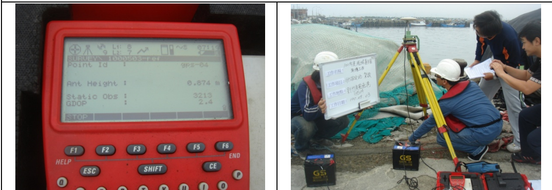
附圖 25-7 潮位儀與 GPS 基站現場檢查照片
