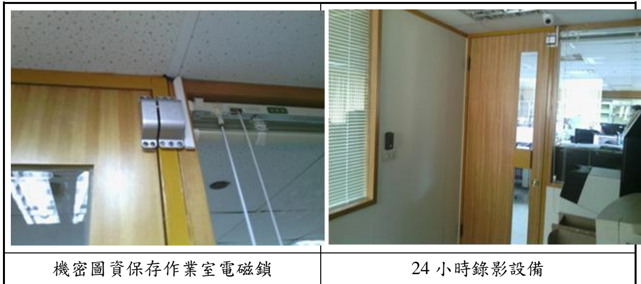
圖 3-73 機密圖資保存作業室各項安全設施
