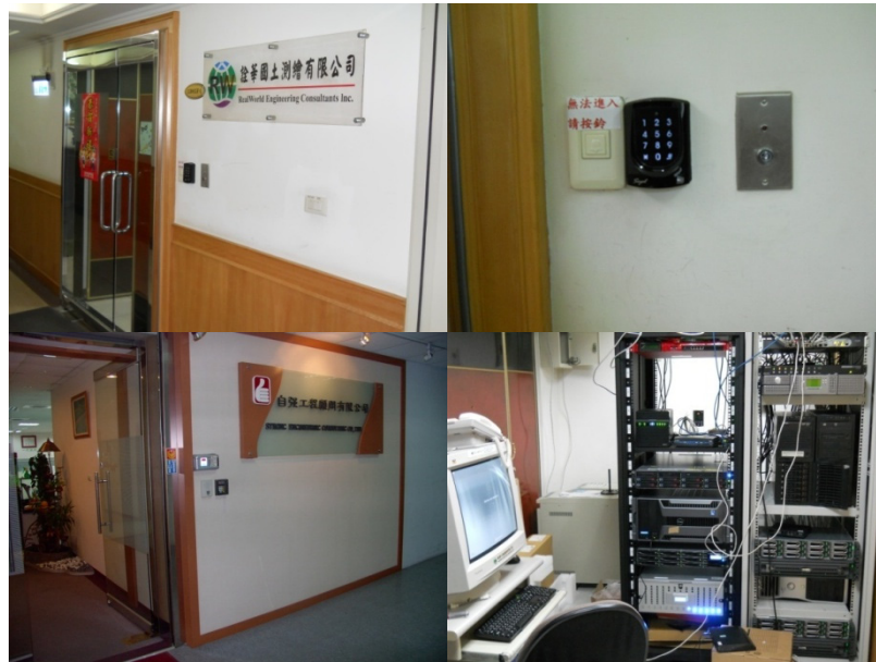
圖5-3、工作場所之門禁管制與機房設備照片
