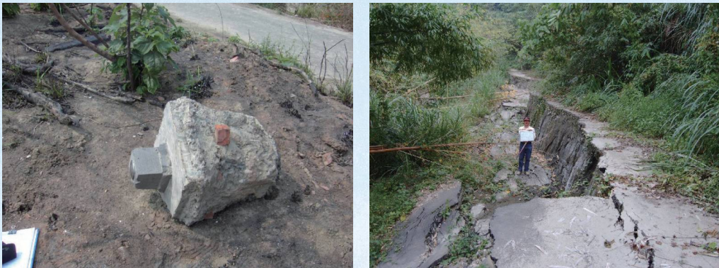
圖 5-1 基本控制點現地遺失損毀情形
