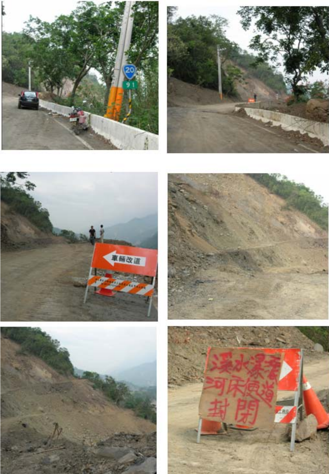
圖 3.2-5 台 20 南橫公路里程 91K 崩塌狀況圖
