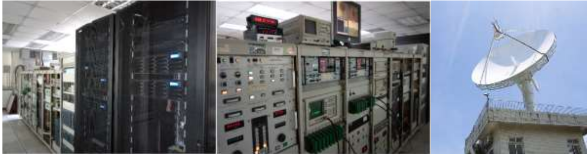
圖 4-2、現有備器設備實況
