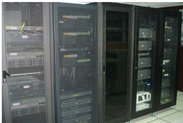
圖 2-3 e-GNSS 系統控制計算中心實景
