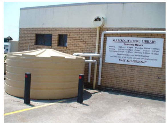
圖 34: 陽光海岸棉樹社區圖書館設置雨水箱，作為公共廁所的替代水源。
