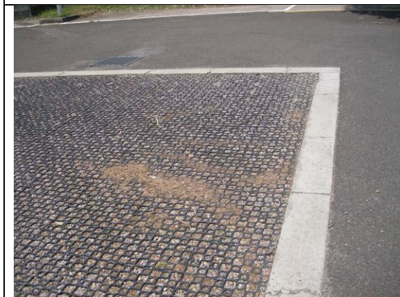
圖 33: 陽光海岸棉樹社區停車場之透水性鋪面，惟已有破損情形
