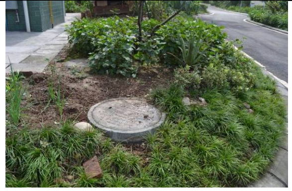
圖 14：南新村管線人孔設置於植栽帶內，道路因此可獲得平整化，避免人孔與柏油路面銜接處失敗凹陷
