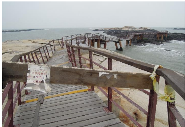
復國墩木棧道已損毀
