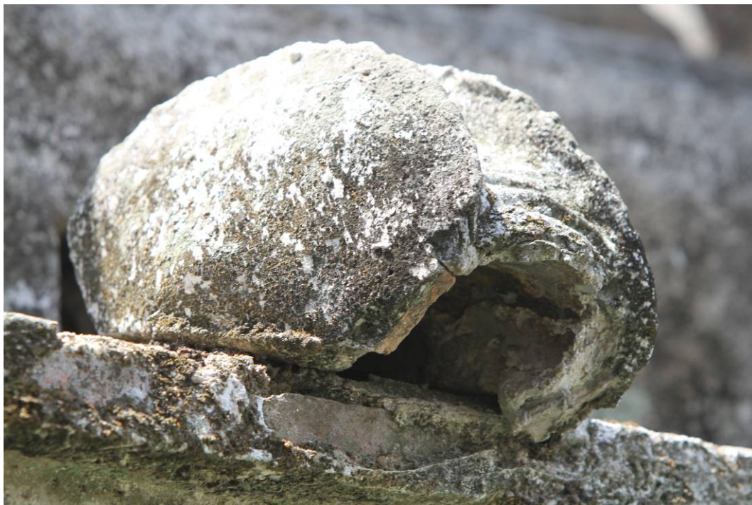
圖 4-3-1 后宅貝殼造型落水口。
