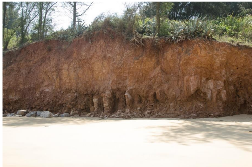
照片 3-2 烈嶼南山頭海灘後方崩壁，是監測的重點
