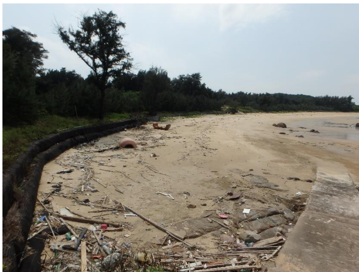
照片 5-6 后嶼坡海岸 2015 颱風後照片，橘色大型浮桶已經被推動
