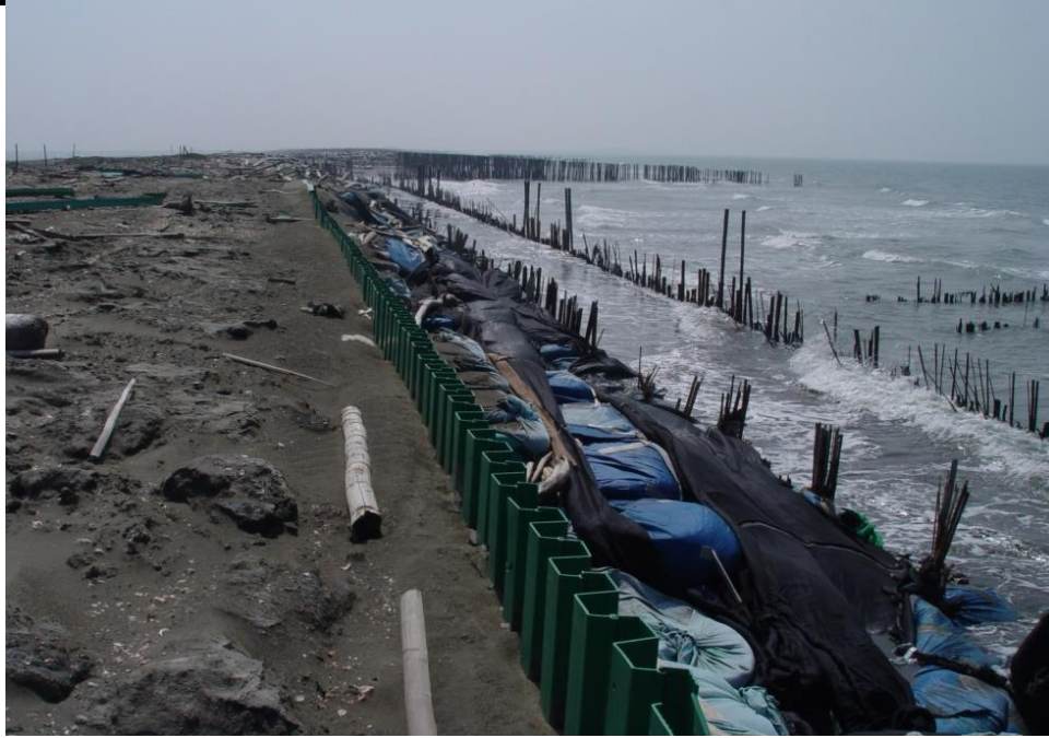
圖 5.2.4 台南七股海岸防止海岸侵蝕的海事固袋、鋼板樁與插竹竿
