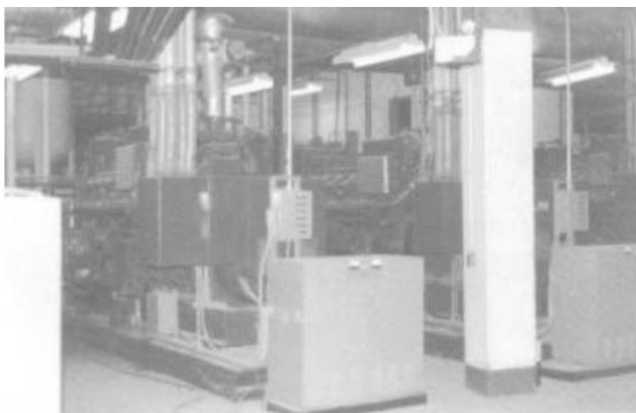
圖 3-9 發電機損壞，造成緊急電源失效 72
