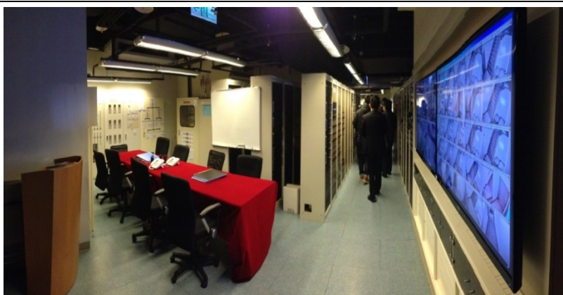
防災中心附設之消防活動空間：防災中心幕僚桌（左）及監控畫面（右）
