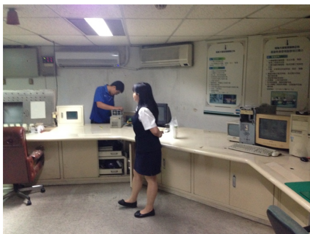
位於地下三樓之防災中心場景，已無在使用
