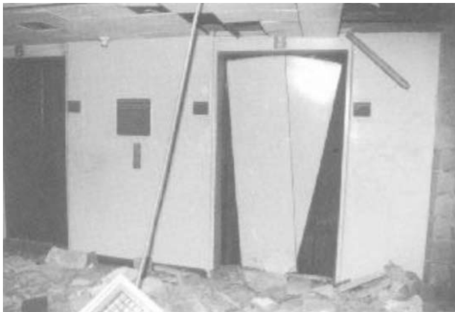
圖 3-8 緊急升降機損壞 71
