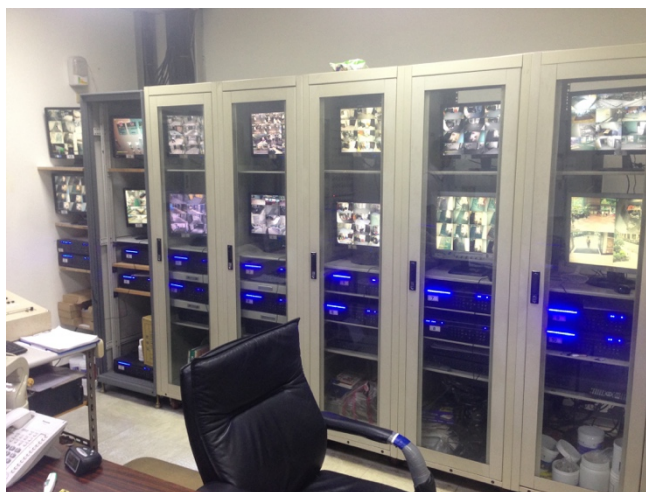
監視畫面（CCTV）
