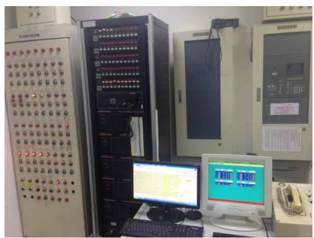
防災監控盤（左）及圖控系統（右）
