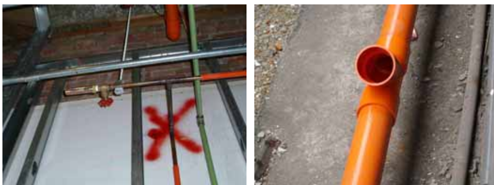
圖5-17 新管路裝設後缺點調查記錄
