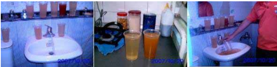
圖5-3 冷水管(PVC管)清洗時水體情況
