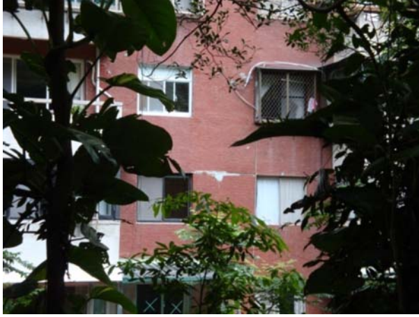
圖7社區建築物外牆剪裂縫
