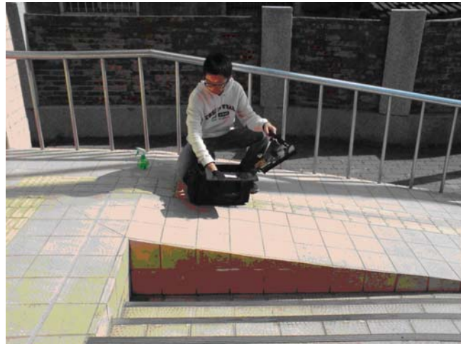
圖2 坡道之坡度過陡，且缺乏扶手及防護緣，有危險之虞
