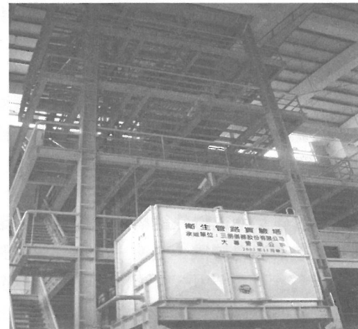
圖 1 衛生管路排水實驗塔現況 (黃信穎攝)
