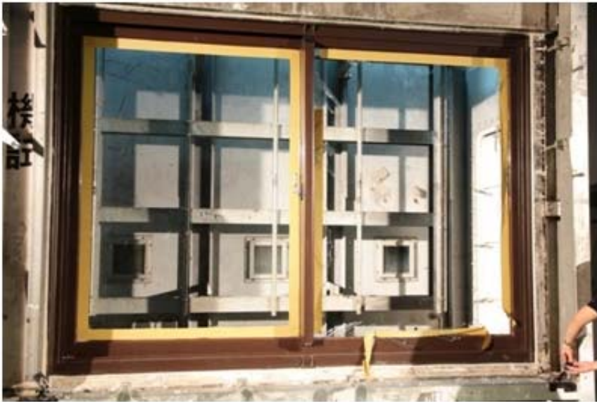
圖11 黏貼口字型膠帶玻璃破裂情形
