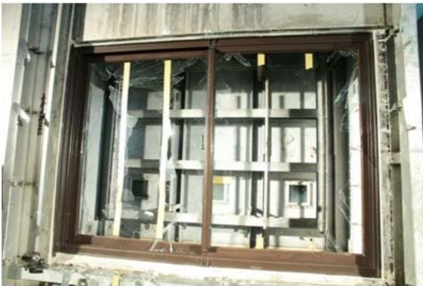
圖9 黏貼井字型膠帶玻璃破裂情形
