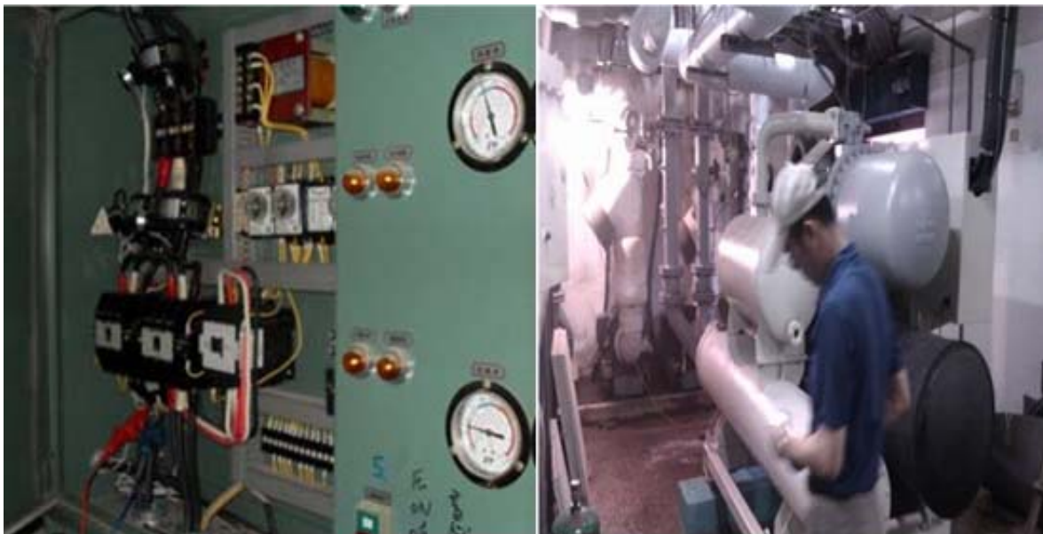
圖1 國立高雄師範大學和平校區圖書館空調主機汰換舊建築改善工程
