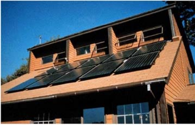
圖3 光電板系統安裝於屋頂
