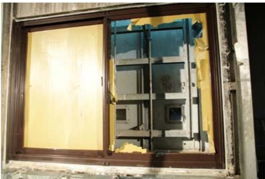
圖13 全部膠帶玻璃破裂情形
