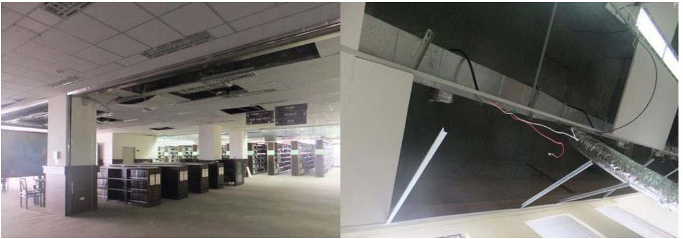
圖9 暨南大學圖資大樓輕鋼架天花板破壞情形
