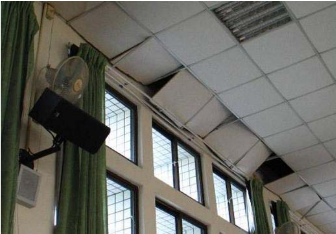
圖3 學校教室天花板破壞情形
