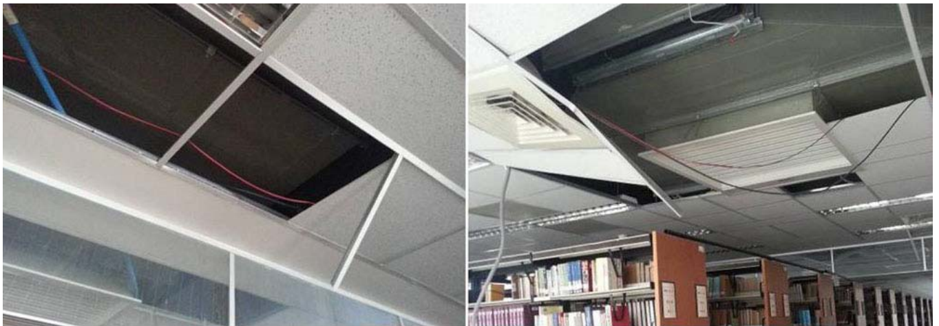
圖1 中興大學圖書館輕鋼架天花板破壞情形
