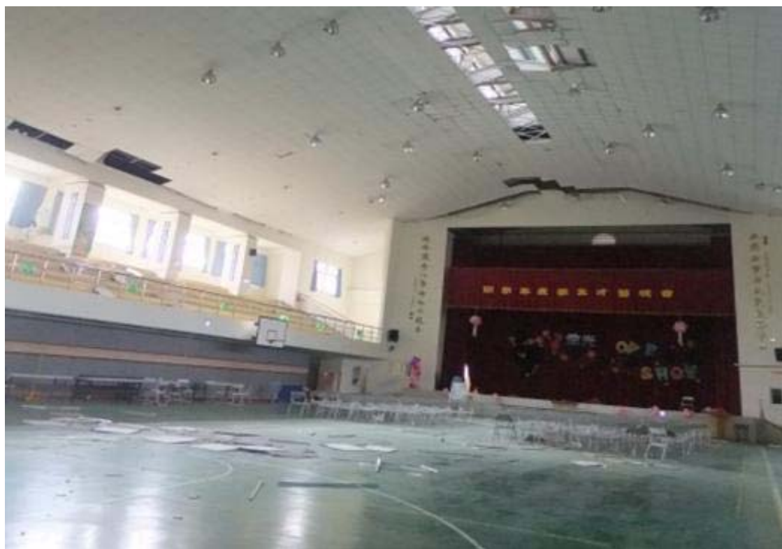
圖8 南光國小天花板破壞情形
