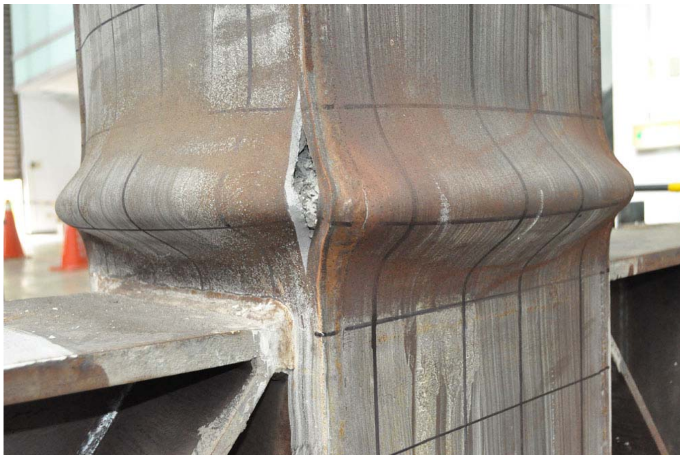
圖10 未加圍束繫桿試體之破壞形狀與角落開裂照片
