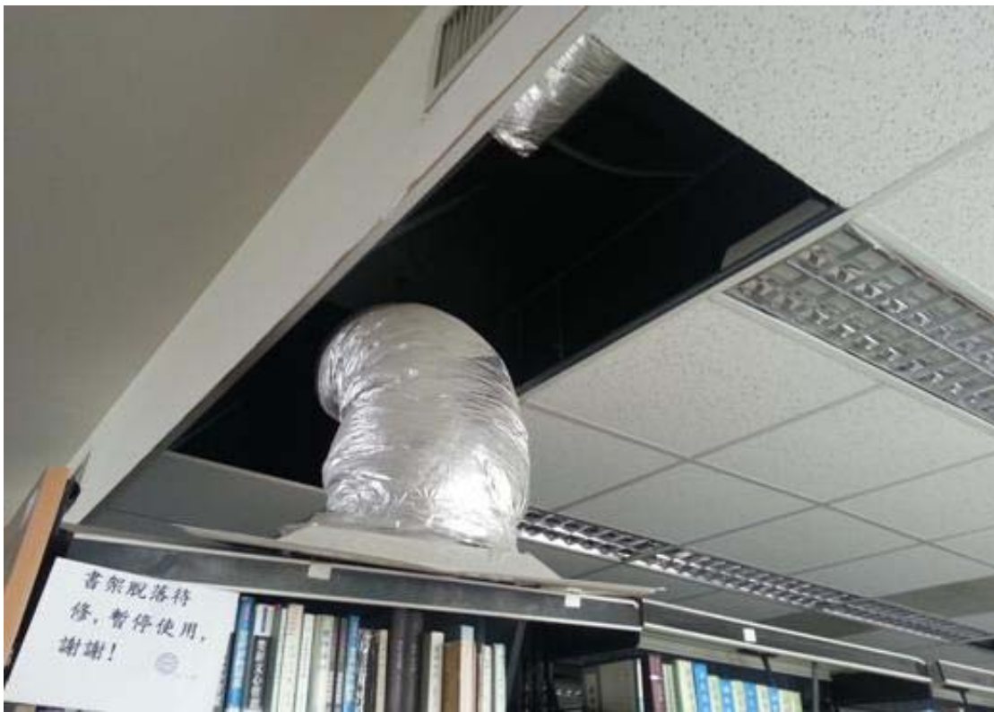
圖5 中興大學圖書館天花板破壞情形
