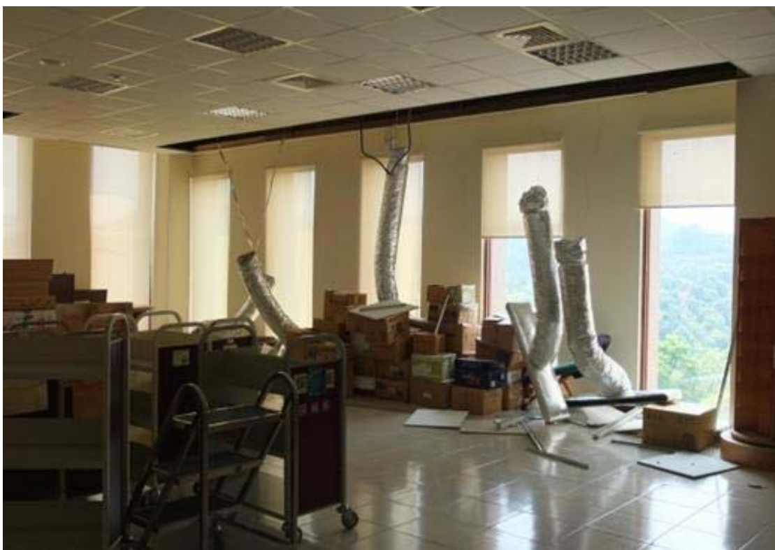
圖6暨南大學圖資大樓天花板破壞情形
