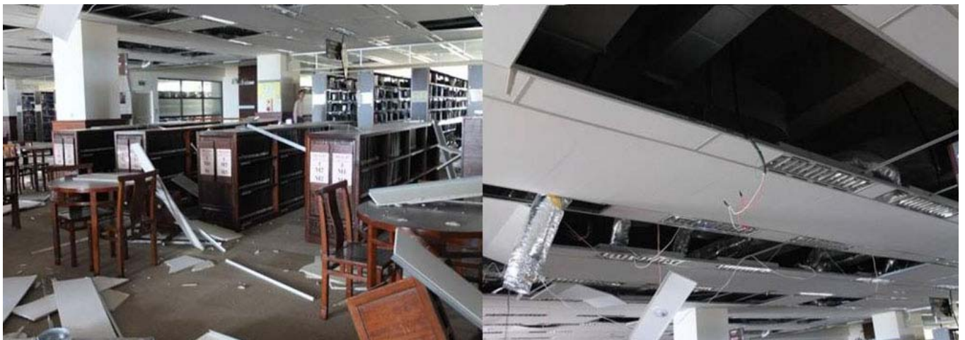
圖2 暨南大學圖資大樓輕鋼架天花板破壞情形
