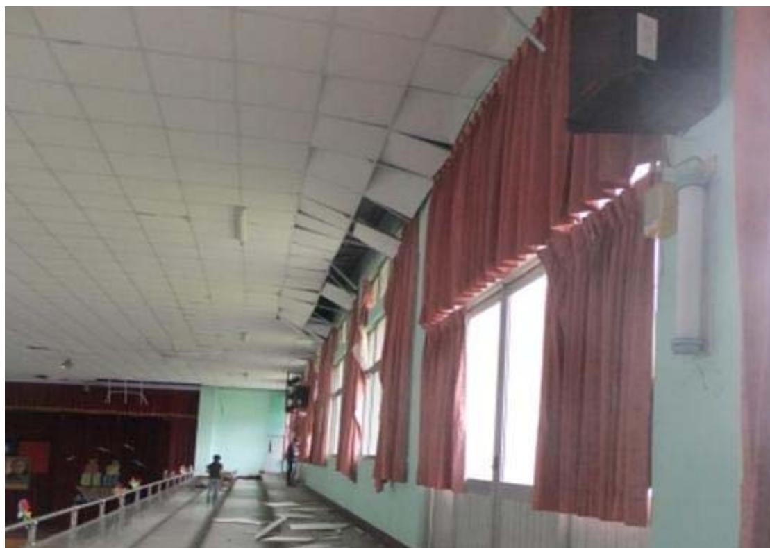
圖7 水里國小天花板破壞情形
