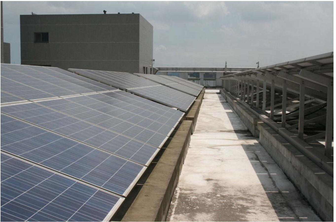
圖6 台達電子桃園三廠屋頂太陽能集電板設置。
