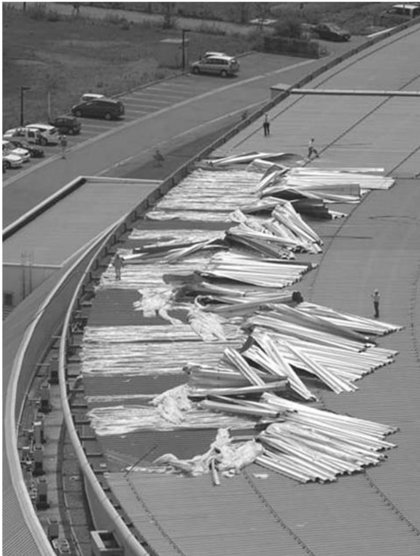
圖8屋頂損壞情形
