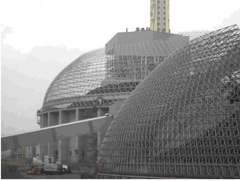
圖5和平電廠煤倉受颱風破壞後之側面圖
