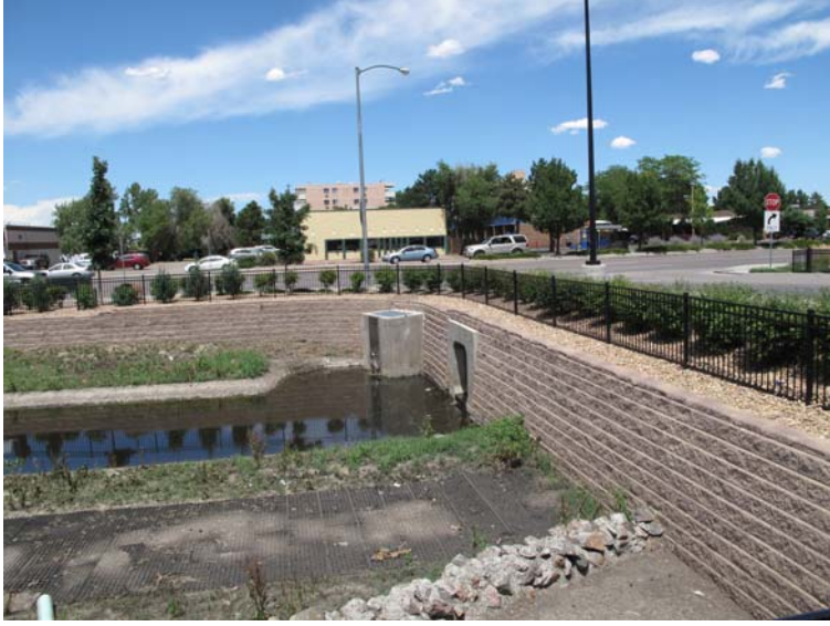
照片14 商業區末端貯洪池(二)右側進水口
