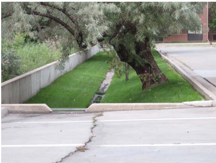
照片12 超大排水溝(二)
