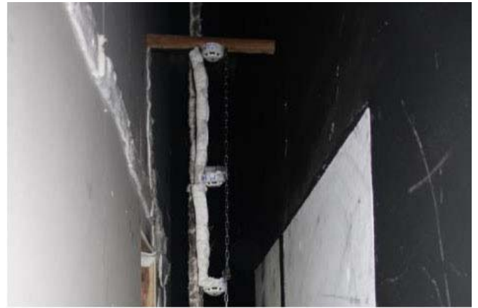
實驗屋出入口偵煙器位置
