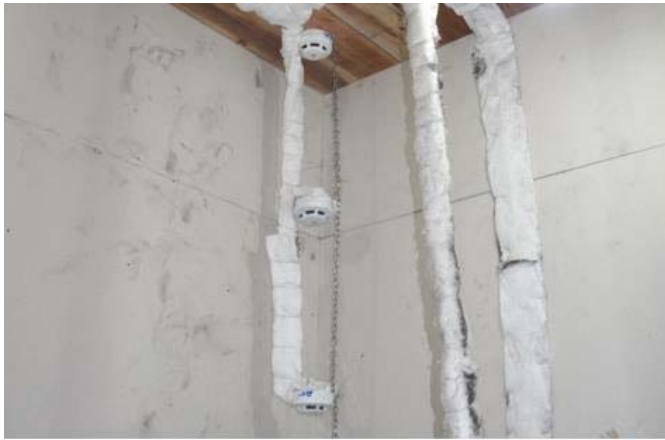
實驗屋內偵煙器位置
