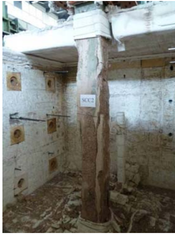
圖1 火害後鋼筋混凝土柱試體
