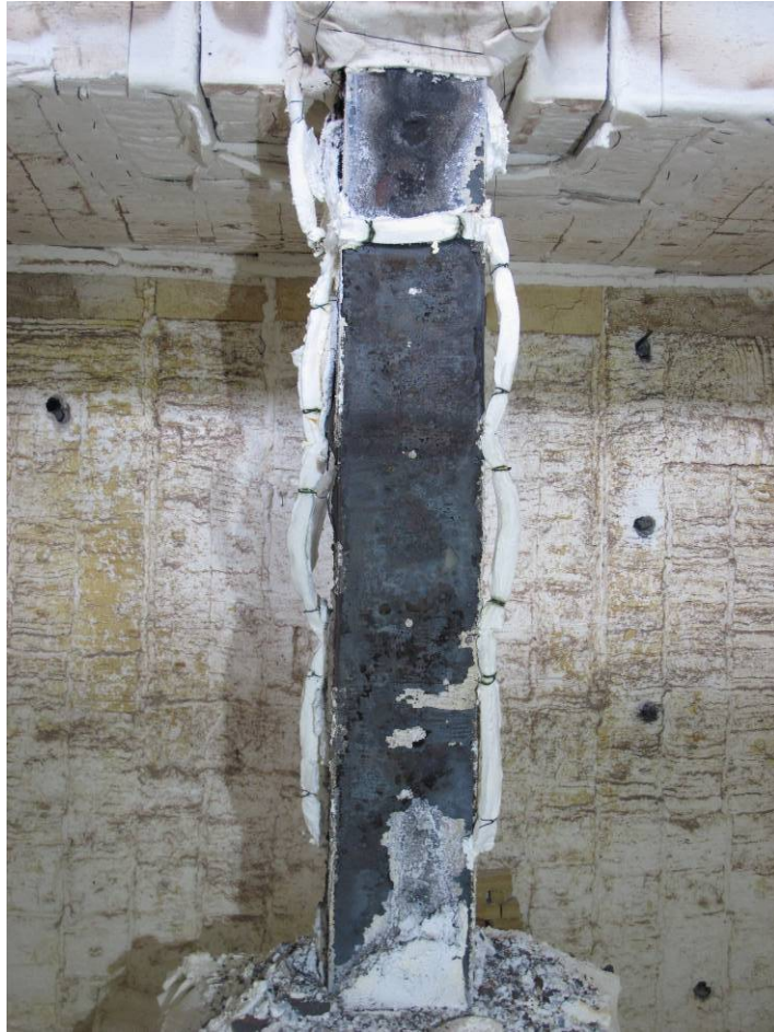
照片3：殘餘極限承載試驗試體破壞照片(1)
