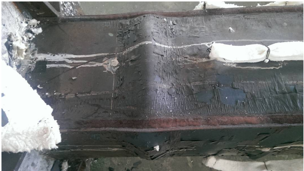
照片4：試驗後試體破壞情況(III)
