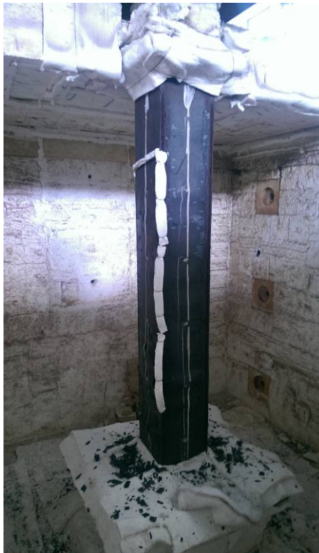
照片2：試驗後試體破壞情況(I)
