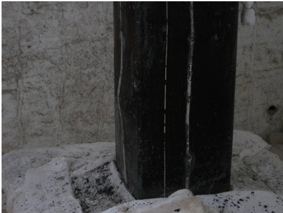
照片4：試驗後試體破壞情況(III)
