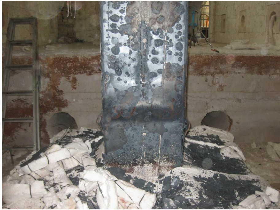
照片3：試驗後試體破壞情況(III)
