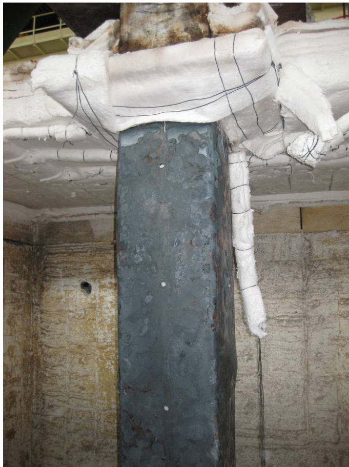
照片4：試驗後柱頂試體破壞情況(IV)
