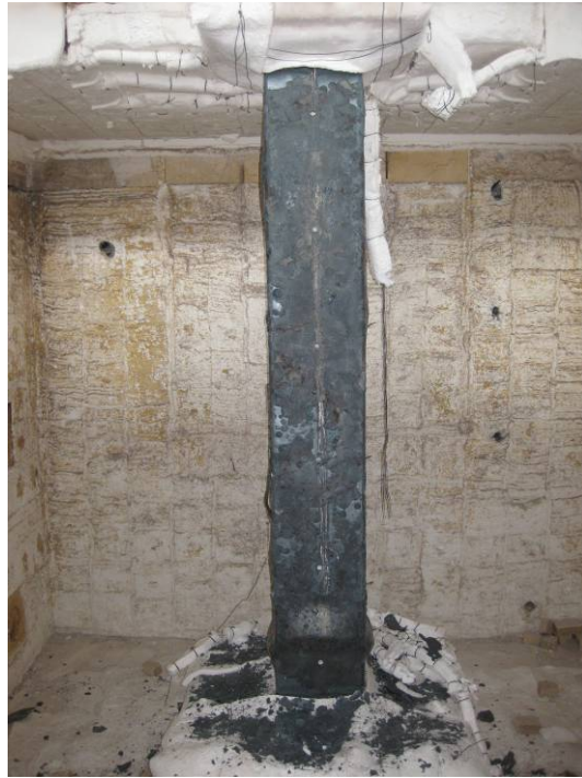
照片1：實驗後試體破壞情形(I)
