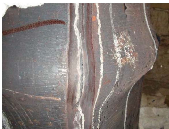
圖 26 試體 PP1 之銲道開裂情形
