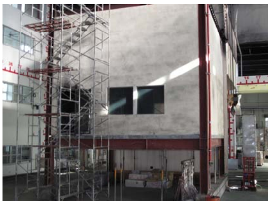
圖 4 10MW 集氣設備實驗屋
