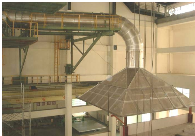
圖 3 集煙罩及各部分管路系統照片圖
