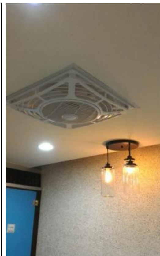
圖五 廁所內採機械換氣，減少廁所臭味。(來源：內政部建築研究所，2015)
