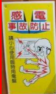
配電盤上鎖及警告標語
