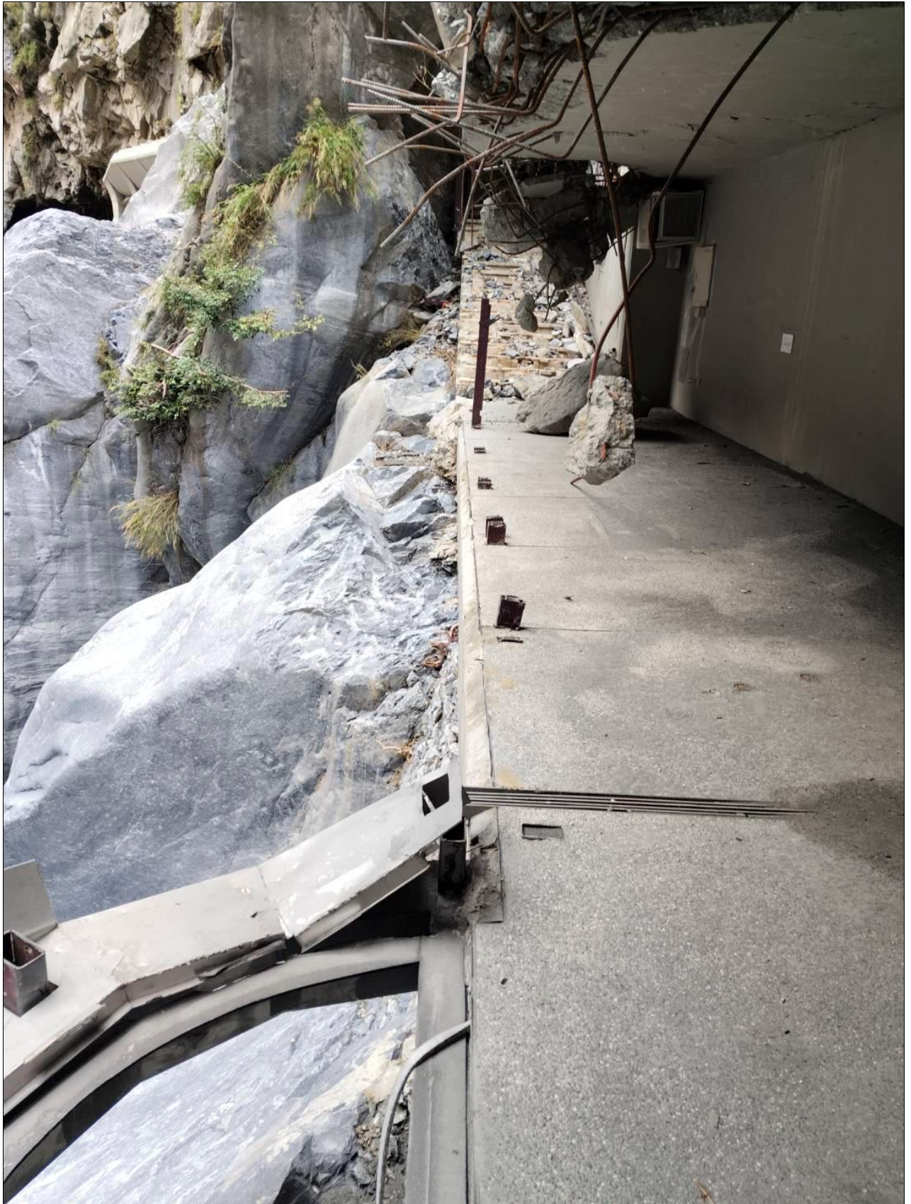
九曲洞水景步道多處護欄及玻璃平臺受洪峰沖毀
