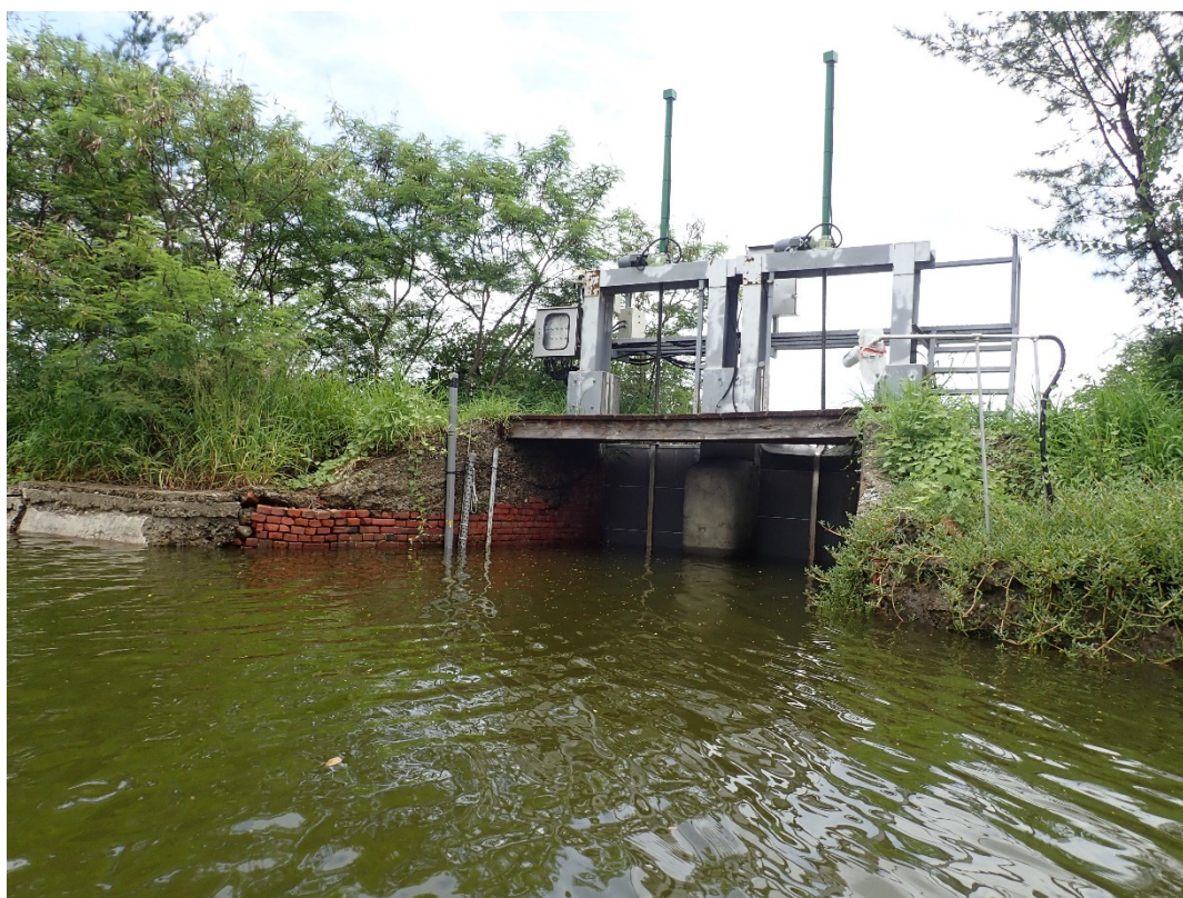
附圖 4-2.4 MG3 閘門(運鹽古運河側)
