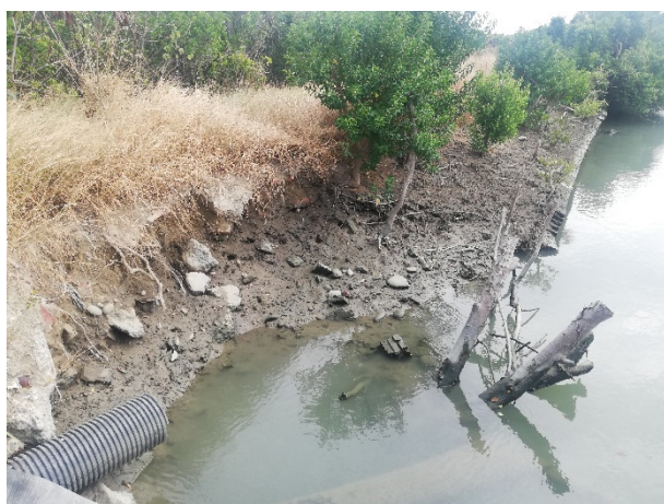
圖 2-2.6 保護區入口處南側左堤岸崩壞狀況圖
