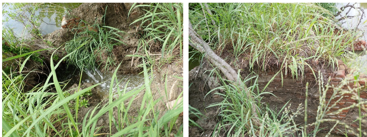
圖 2-2.9 B23 區閘門土堤掏空圖
