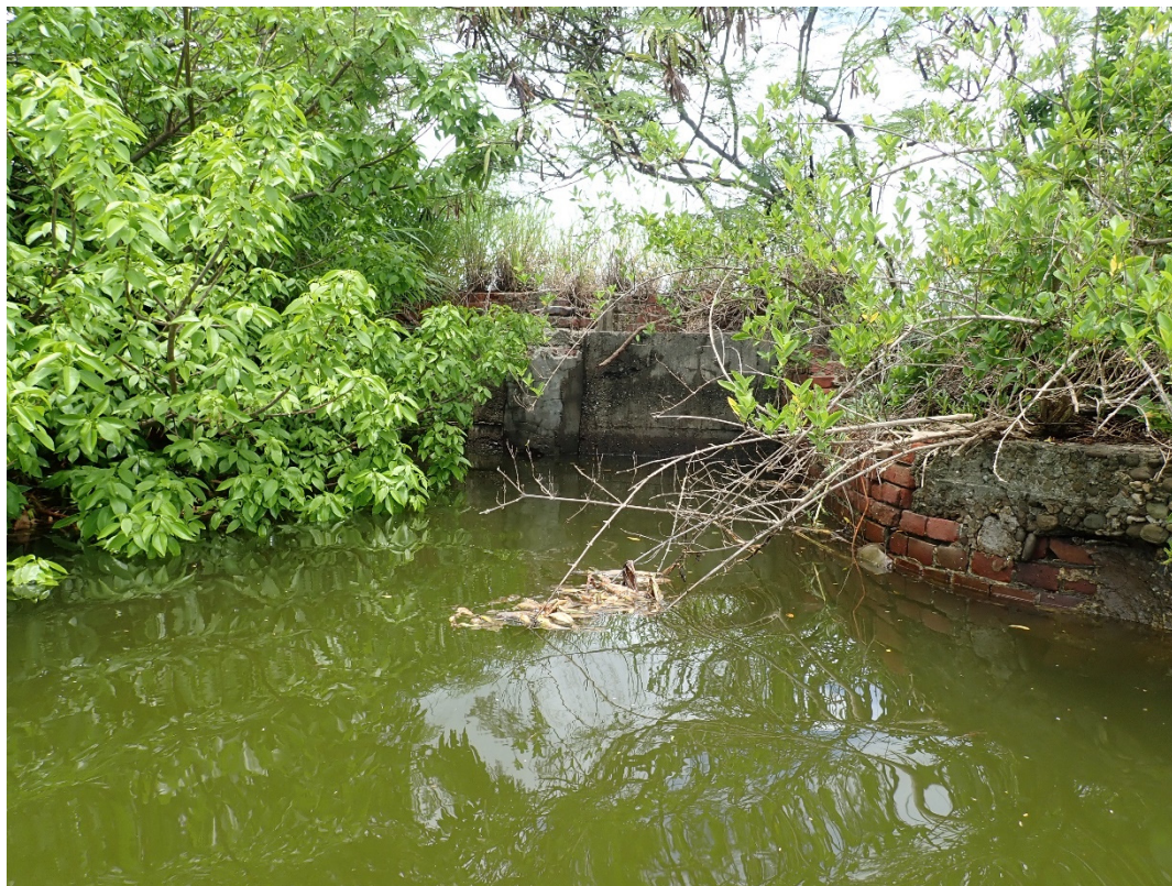
附圖 4-2.5 MG4 閘門-1(運鹽古運河側)
