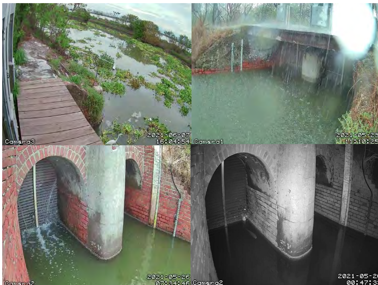
圖 2-3.6 增設 B8 樣區東側防潮閘影像監視系統畫面圖
