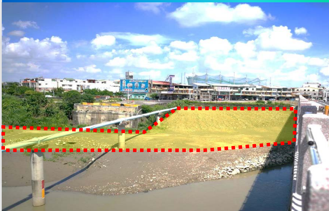
堤防護岸填方復原後，呈現裸露地。
